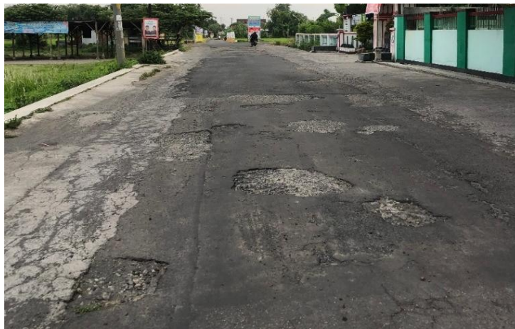
Gambar 1. Infrastruktur Jalan Rusak
